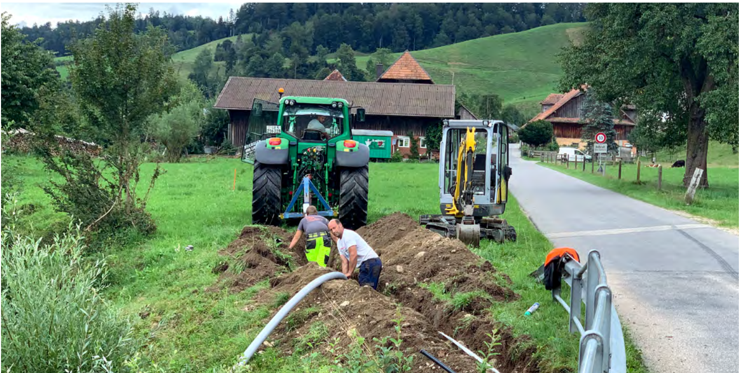
In der Pilotgemeinde Luthern konnte das neue Glasfasernetz zusammen mit lokalen Unternehmen bereits fast vollständig unter Boden verlegt werden. Bild: GFA Luthern
