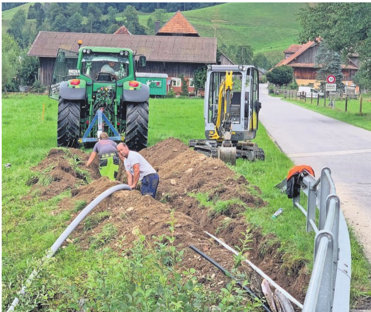
In der Pilotgemeinde Luthern sind 95 Prozent der Haushalte an das neue Glasfasernetz angeschlossen. Foto zvg
